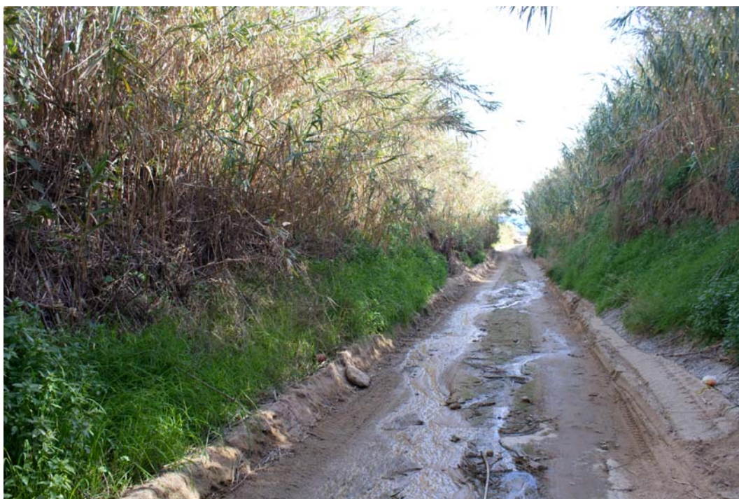
Foto 7: Vista aigües avall de la llera a l'alçada de la secció 114,11. S'observa que al marge esquerre hi ha un talús recobert de canya ( Arundo donax ) enlloc del mur perimetral.
