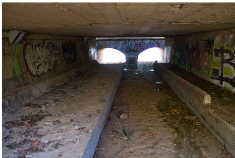
Fig.9 Fotografia obra de pas per sota les vies del ferrocarril des de l'interior de l'obra de pas de la carretera N-II
