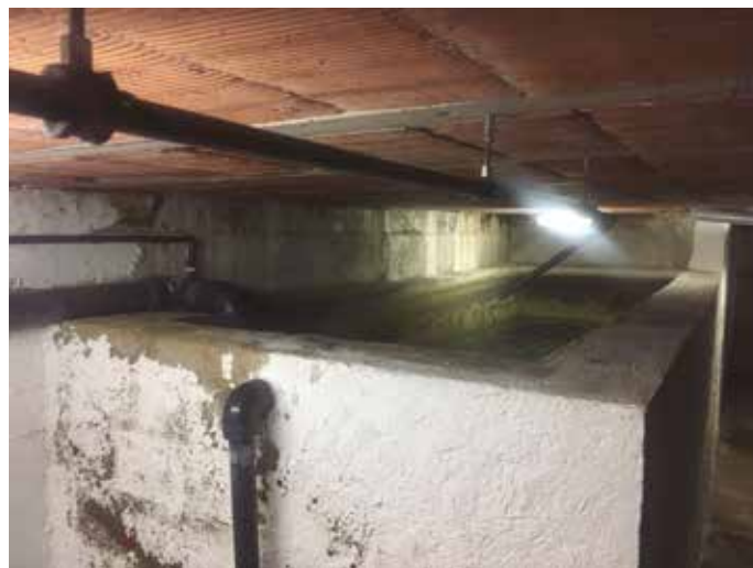
Dipòsit de compensació obert. Foto: Matías Argilés
