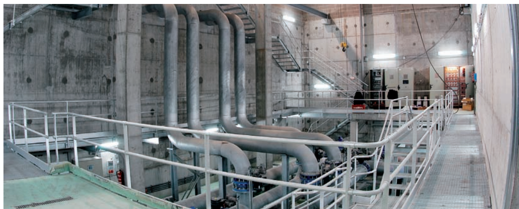
Sala de control del dipòsit Roca Blanca
